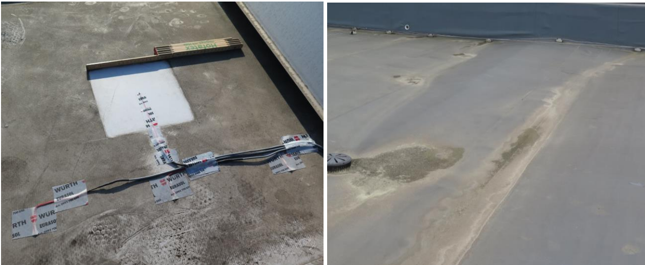
Abbildung 7: Verfärbungen der Dachhaut durch Verschmutzung: links: helle Dachbahn nach 5 Jahren, kleine quadratische Fläche gereinigt, Temperaturfühler HFA zur Messung der Oberflächentemperaturen. rechts: dunkle Dachbahn nach 2,5 Jahren, augenscheinlich hellere Stellen durch Ablagerung von Schmutz.
